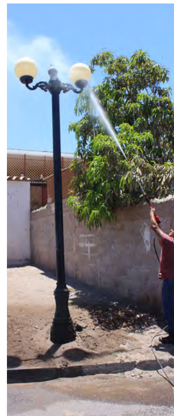
MEJORAMIENTO DE LUMINARIAS Una de las tantas tareas cumplidas en esta nueva gestión.
